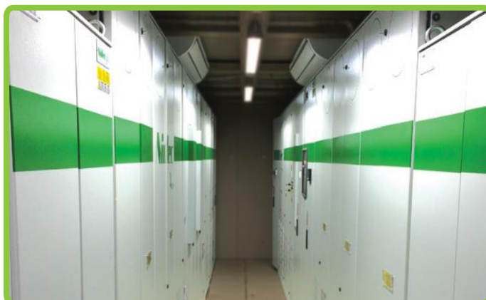
"Ginestra 2.4MW" изглед отвътре на кабината на PCS
