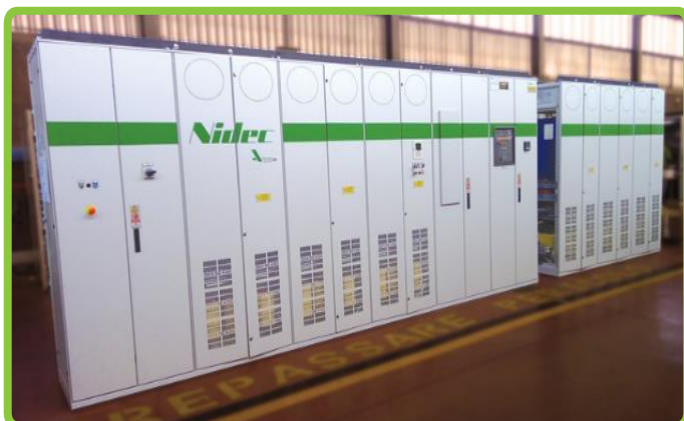
"Ginestra 2.4 MW" PCS – AC/DC секция
